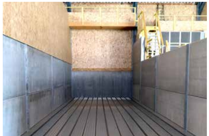
Heutrocknungsanlage mit kombinierter Flächenrost-trocknung zur Trocknung von diversen Schüttgütern.
