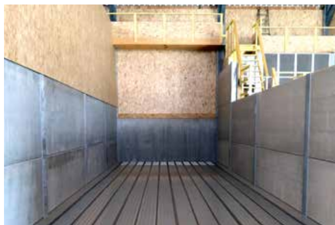
Installation de séchage du foin avec grille de séchage combinée pour le séchage de divers produits en vrac.
