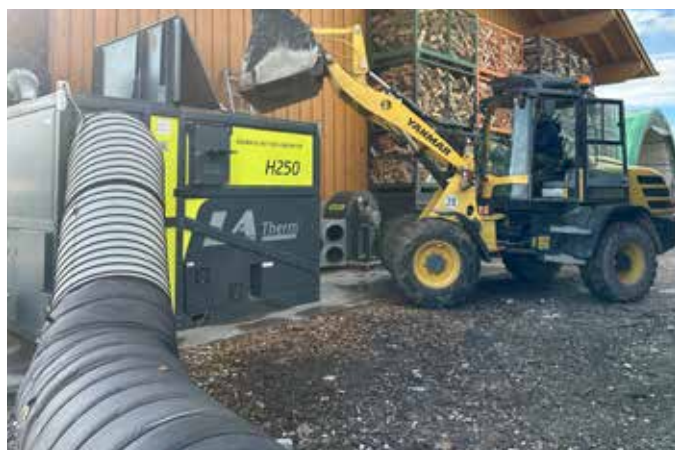
Remplissage facile du H250 avec un chargeur frontal. Le H250 est directement relié à deux conteneurs de séchage.
